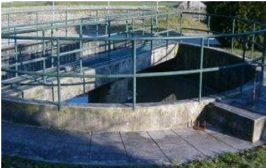
Vue d'une partie de la station de traitement des eaux résiduelles actuelle.
